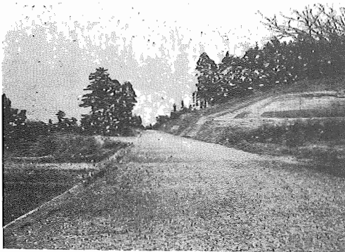
○県道船橋～取手線 新設道路 延長600m 巾員11mが完成した (三ヶ年継続事業) 工事費 450万円
