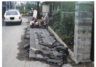
▲控壁がなく道路へ倒壊した塀
