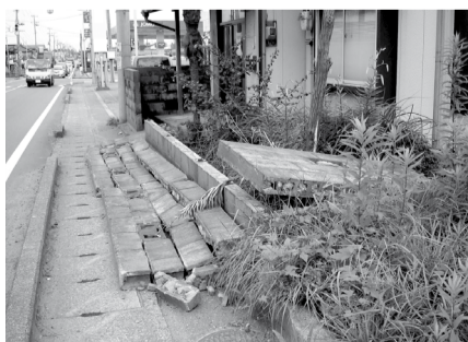
▲鉄筋や控壁(支え)がなく歩道へ倒壊した塀
