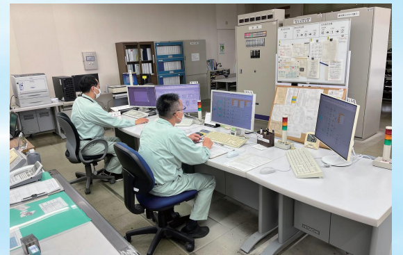
▲妻子原浄水場中央操作室
