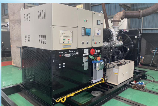
▲妻子原浄水場新非常用発電機
