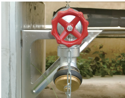
▲受水槽からの取出口
