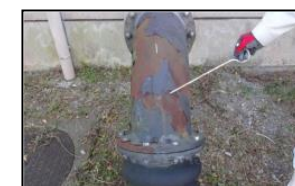
No1雨水ポンプ吐出口
