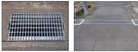
緊急対策 (グレーチング蓋)
